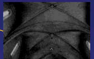
Arcs brisés en ogive typiques de l'art français destinés à soutenir la voûte.
